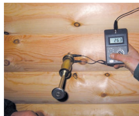
Diese gemessene Feuchtigkeit von 26,3% ist eindeutig zu hoch.
